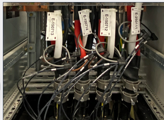
Installierte Current Link-Module pro Abgang
